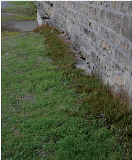
Saint-Julien-le-Petit : bruyères, ajoncs et autres plantes au pied des murs intérieurs et extérieurs
